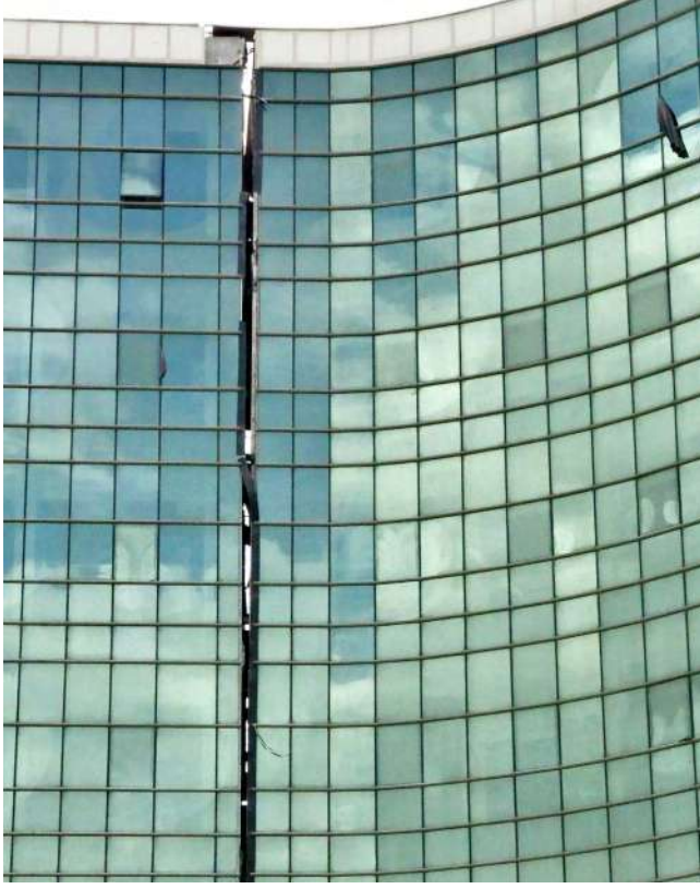
Sahra hastanesinde oluşan hasar...
